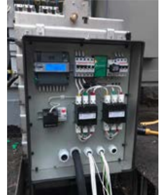
Подземный пункт питания на улице Сургина
