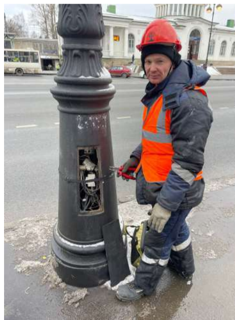
Александр Сергеевич Комаров, электромонтер по эксплуатации распределительных сетей 5 разряда Пушкинского эксплуатационного района
