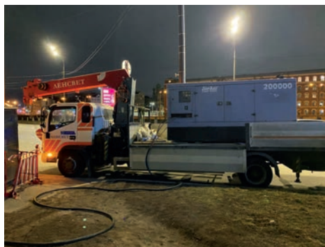
Работа генератора на месте дефекта
